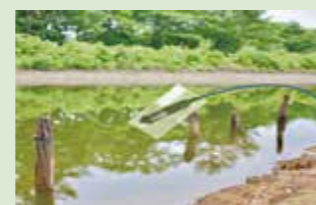
河川の水位監視 (水位センサーを追加接続)
